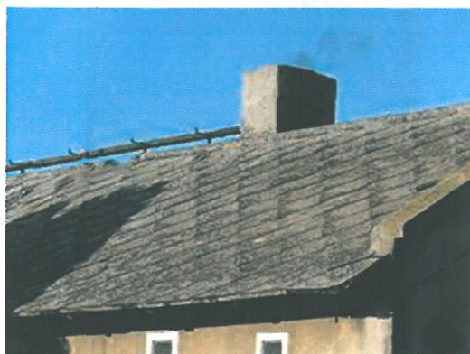
Rys. 4 Płyta azbestowo-cementowa karo
